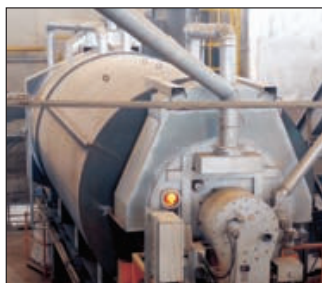
Particolare impianto di desorbimento termico
