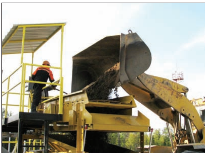
Impianto di incenerimento del terreno contaminato
